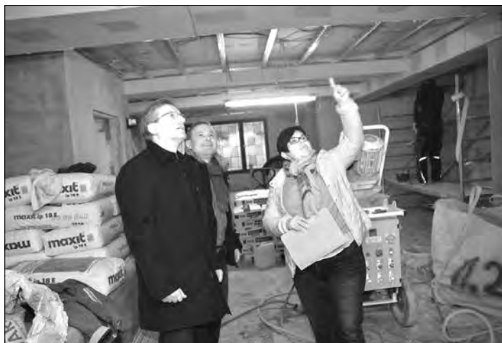
Noch wird im Haus fleißig gewerkelt und saniert. Elisabeth Baierlein zeigt Bürgermeister Rainer Detsch (links) den Baufortschritt. Mit im Bild Bernd Baierlein.
