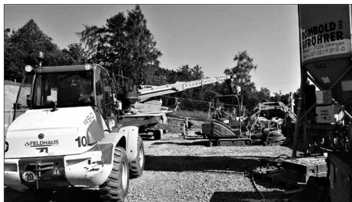
Schweres Gerät wird bei der Herstellung eines neuen Zugangsschachtes zum K. b. Maximilian-Erbstollen westlich des Stockheimer Friedhofs eingesetzt.
